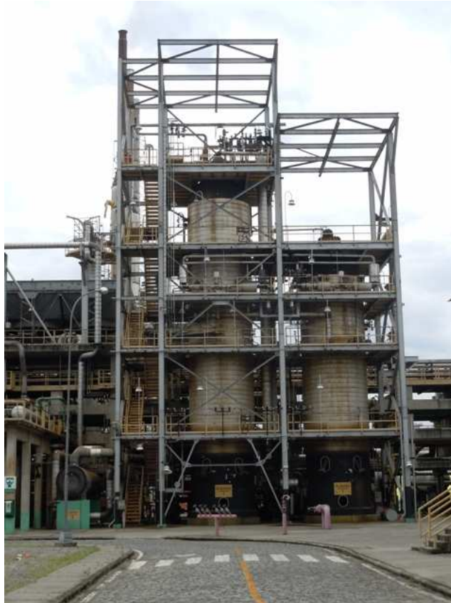
Figura 2.15: Reatores industriais de hidrotratamento.
