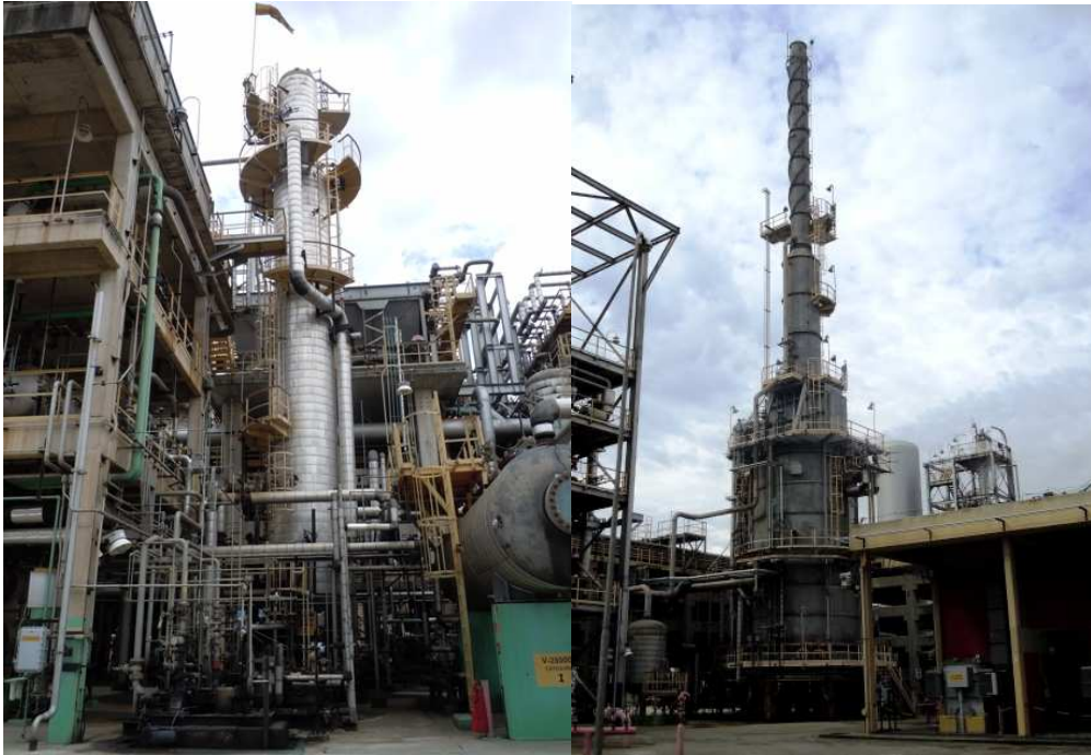
Figura 2.16: Torre retificadora (esquerda) e forno de carga (direita).
