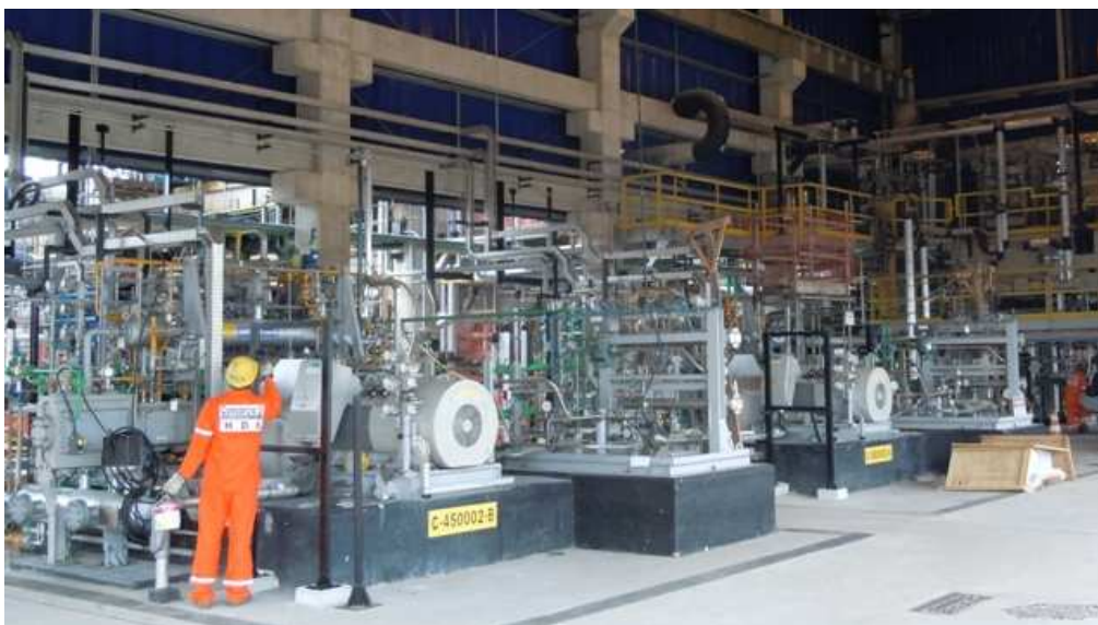
Figura 2.18: Compressores de uma unidade de HDT.
