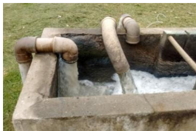
Figura 3.2: Entradas de Esgoto Bruto no CESA/UFRJ. Tubulação FUNDÃO à esquerda e VILA ao centro. Fonte: Arquivo Pessoal
